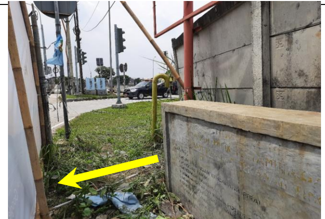
Rencana Pemasangan Pipa JDU HDPE di Jln. Kukusan Ø 200 mm crossing dengan jalur pipa gas PT. Pertamina Gas
